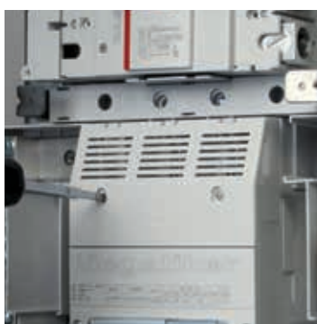
CUBIERTA AISLANTE INTERRUPTOR PRINCIPAL
